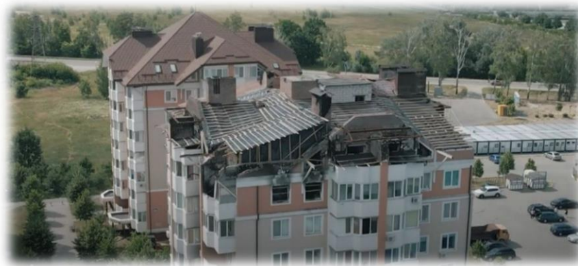
Фото 4. Багатоквартирний житловий будинок по вул. Бориса Гмирі, 2 у м. Буча Бучанського району Київської області (з сайту http://surl.li/abcsro )
