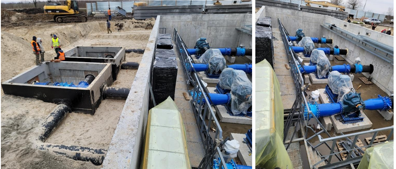
Фото 1. Стан будівництва підземної насосної станції магістрального водогону Хортиця (ДВС 2) – Томаківка – Марганець поблизу с. Червоногригорівка (16 лютого 2024 року)
